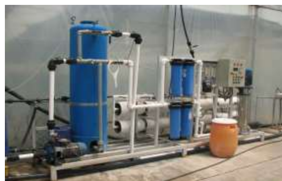
شکل ۶- سیستم نمک‌زدایی از آب به روش اسمز معکوس، نصب‌شده در یکی از گلخانه‌ها
