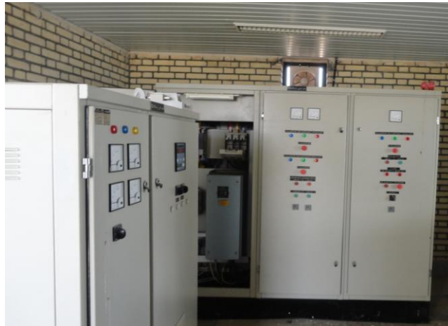
شکل ۳- اجرای سامانه کنترلی مدیریت هوشمند ایستگاه پمپاژ (شهرستان بيله سوار مغان)
