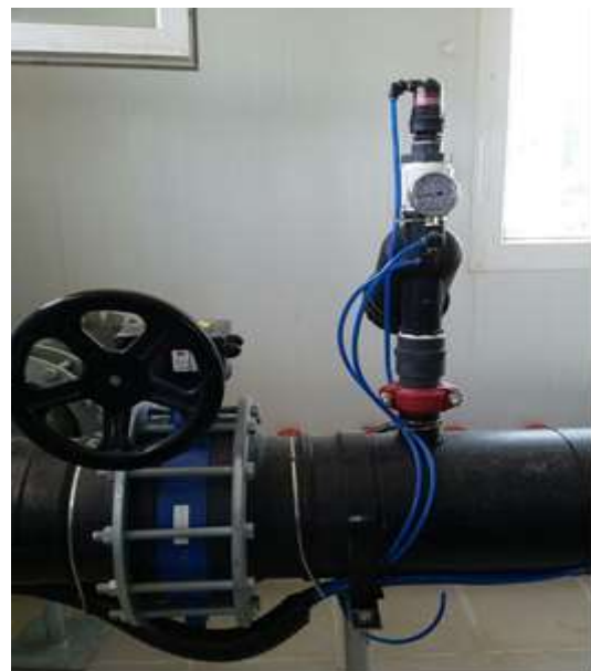
شکل ۹- ادوات پایش و کنترل فشار در ایستگاه کنترل مرکزی
