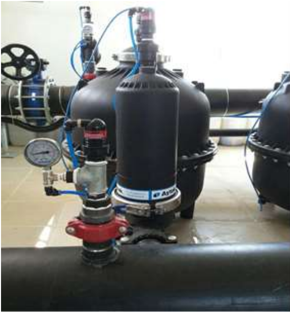
شکل ۱۰- ادوات پایش و کنترل فشار در فیلترهای دیسکی
